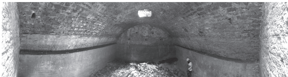
Slika 7. Cisterna tvrđave sv. Ivana, zatečeno stanje prije projekta revitalizacije (fotografirao: Josip Pavić).
